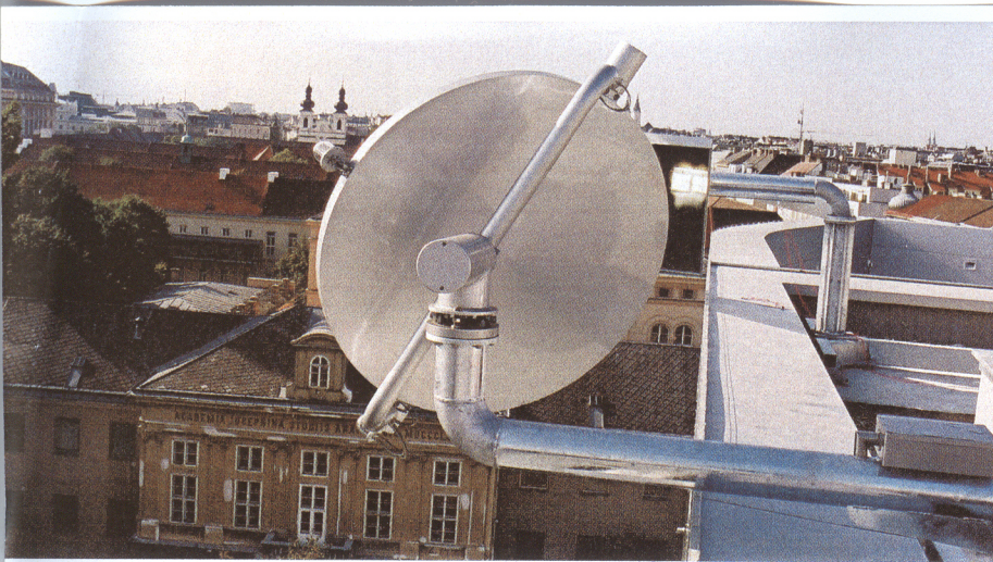
Heliostat Et Mirror am Dach
